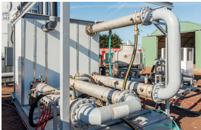
Vue de l'installation de traitement de la créosote sur charbon actif.
